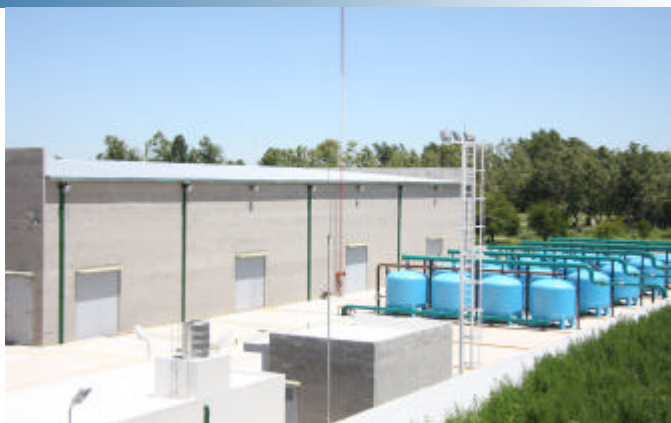
Planta de Tratamiento por Osmosis Inversa de Virrey del Pino.
